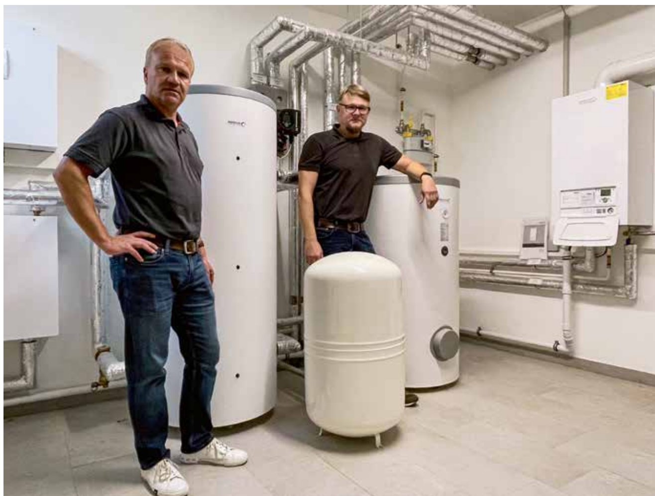
BRÖTJE-Techniker Tom Neitzel (links) und Markus Dittrich vom SHK-Betrieb Weigel & Unger (rechts) sind sehr zufrieden mit den hybriden Heizungsanlagen.
