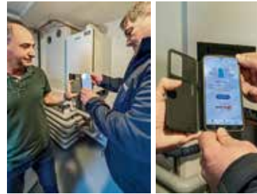
Bauherr und Elektromeister Orhan Budak (links) und Salvatore Aleo, Technischer Außendienst für den Hersteller BRÖTJE (rechts), prüfen die Heizungsregelung. Sowohl Inbetriebnahme als auch die Alltagsbedienung des Hybridsystems funktionieren bequem per App.
