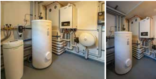
Ein aufgeräumter Heizungskeller: Rechts neben dem bodenstehenden 200-l-Pufferspeicher hängen drei Geräte in einem Kasten – 1. der Gas-Brennwertkessel WGB 22.1, 2. das Wärmepumpen-Anschlussset Kit 65, 3. die gemeinsame Hybridregelung für alle Komponenten.
