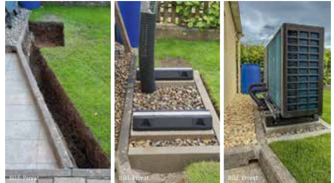
Die Leitungen zur Außeneinheit hat der Eigentümer dezent unter dem Rasen verlegt.
