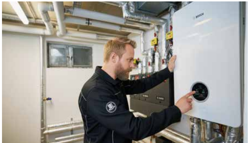
Symbolbild: Ein Schornsteinfeger bedient die Compress Hybrid 5800i G im Wärmepumpenbetrieb.
